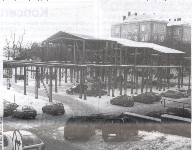
Jest nadzieja, że może już w najbliższym czasie budowa-widmo przestanie szpecić centrum miasta.
