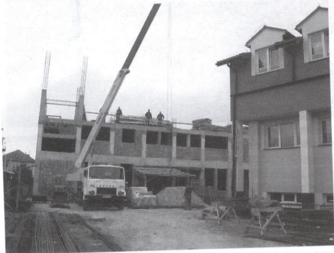
Z tyłu budynku gimnazjum w Nowym Zagórz szybko rośnie hala sportowa wraz z krytą pływalnią i zapleczem socjalnym.
