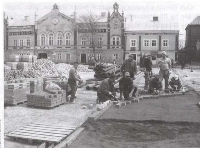
Nawierzchnia Rynku zostanie ułożona z różnych rodzajów kostki oraz płyt, zgodnie z opracowanym przez projektantów wzorem.
