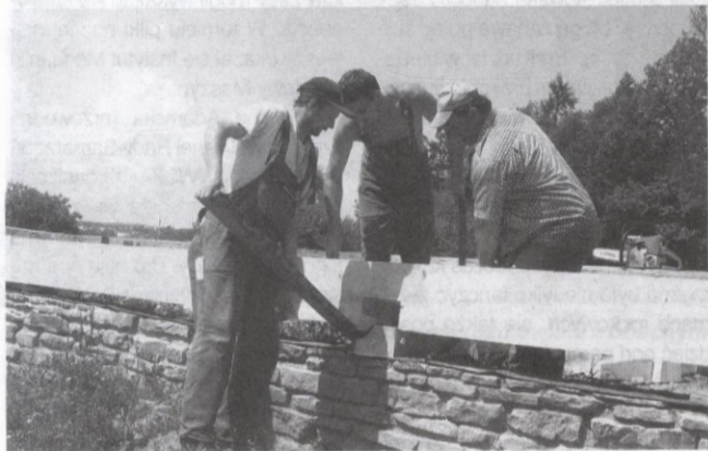
Opasanie budynku pierwszą belką, nazywane też założeniem wieńca, było oficjalnym momentem rozpoczęcia budowy dworu. Jego wymiary 27,9 m długości i 14 m szerokości.
