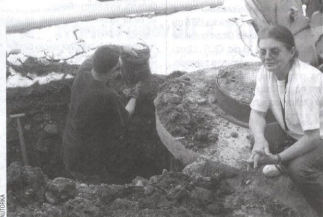
W związku z pracami przy rewitalizacji rynku p. Maria Zielińska niemal każdy dzień spędza w wykopach.
