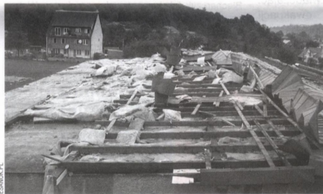
Naprawa zerwanego dachu kosztować będzie ok. 80 tys. zł.
