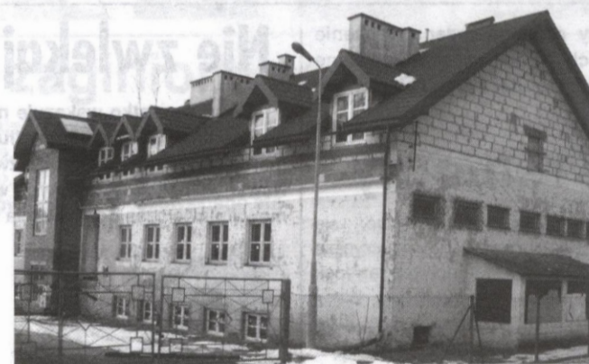
Na miejsca w tym obiekcie czeka ok. stu obłożnie chorych osób. Tymczasem nie widać chętnych, którzy pomogliby Towarzystwu Brata Alberta w dokończeniu jego remontu.
