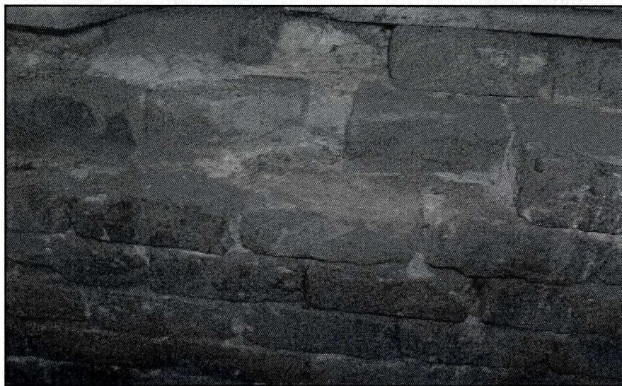
Fragment zniszczonego muru przy wejściu na chór i wieżę kościelną.
