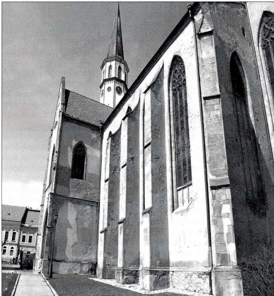
Zewnętrzna strona prezbiterium Fary Św. Jakuba wymagająca renowacji
