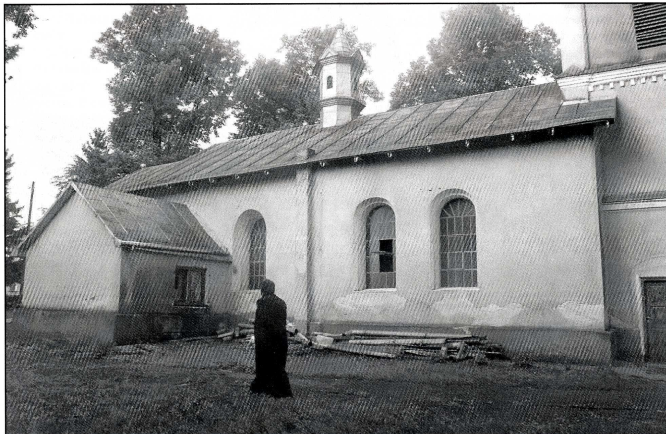
Stary kościół w Trepczy wymaga remontu...
