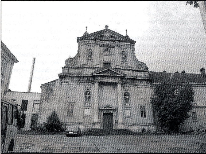
zniszczona fasada kościoła Matki Bożej Gromniczej
