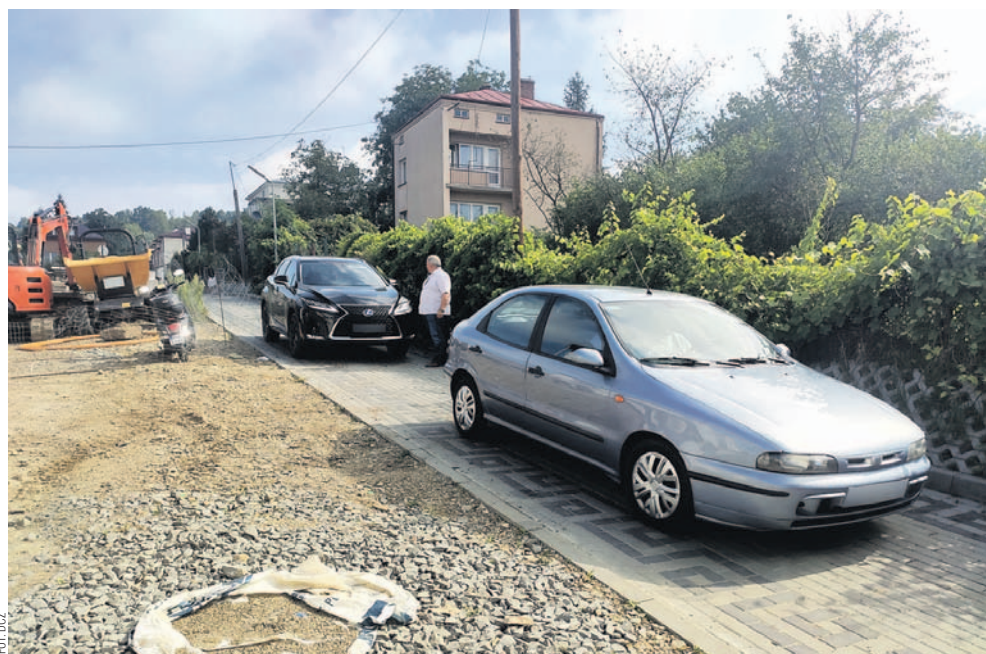
Samochody na wąskim odcinku ul. Jasnej mają utrudniony wyjazd z posesji
