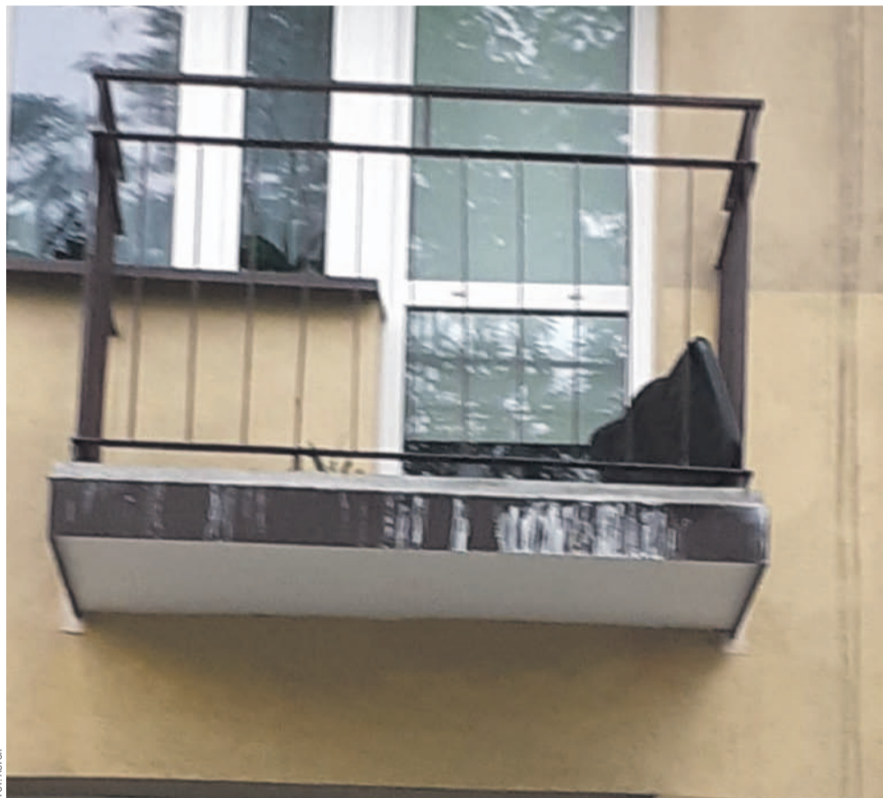
Zdjęcie zacieków z ul. Daszyńskiego 3 (w całej spółdzielni to tak wygląda).
