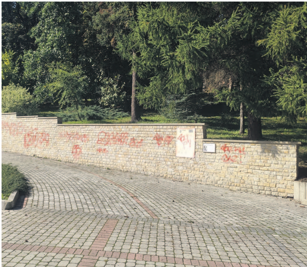
Wandalie zniszczyli elewację muru na placu Harcerskim
