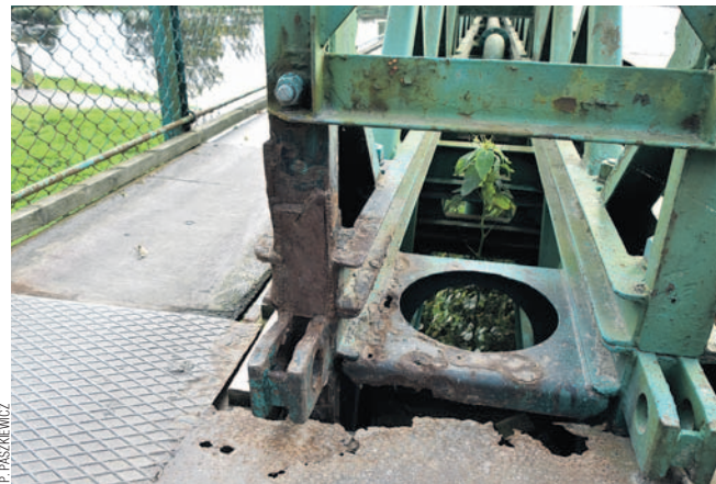
Skorodowane elementy Mostu Białogórskiego
