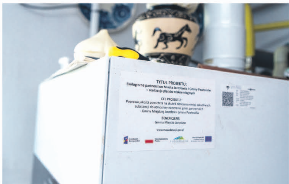
Instalacja kotłów gazowych kondensacyjnych oraz kotłów na biomasę.
