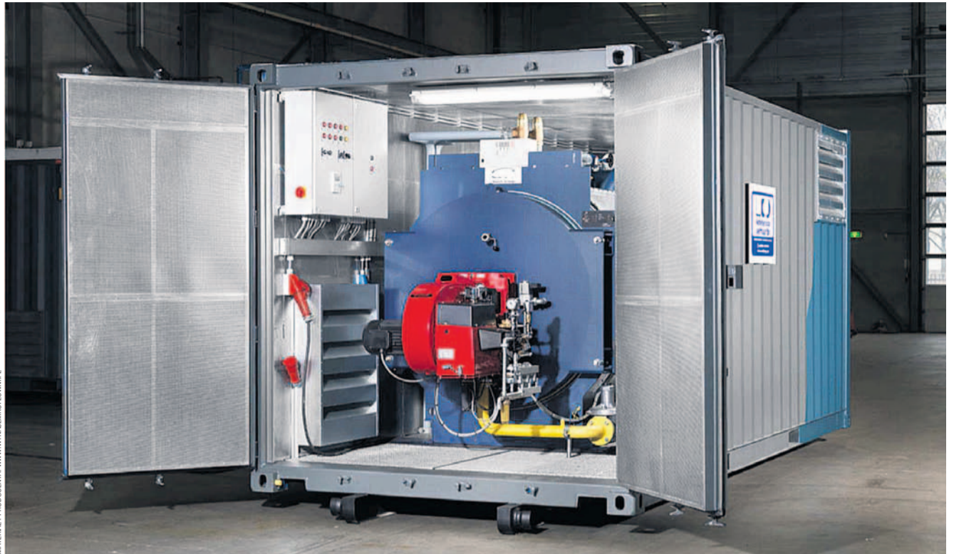
Wnętrze kotłowni kontenerowej
