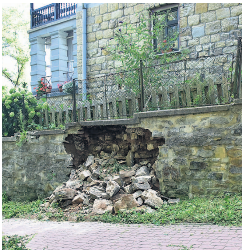
Sypiący się mur przy willi Zaleskich
