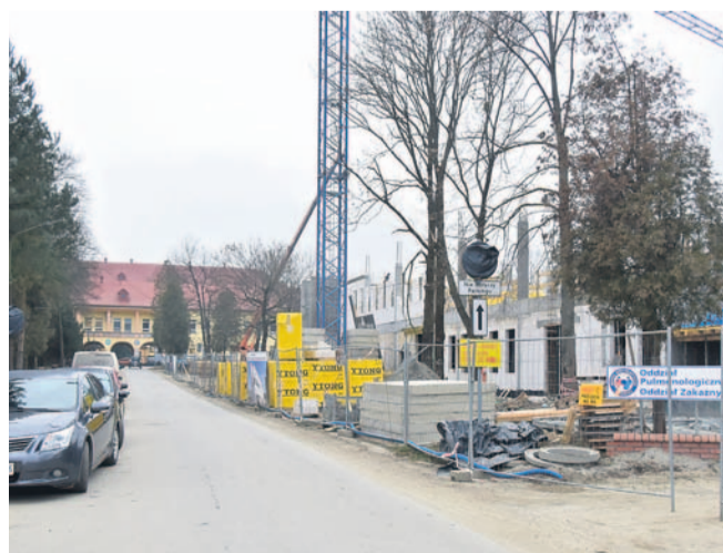
Po rozpoczęciu budowy zniknęła część miejsc parkingowych, a droga do szpitala znacznie się zwęziła
